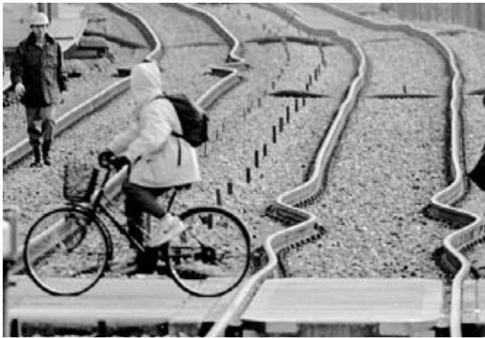
FIGURA 15.14 Expansión térmica. El calor extremo de un día en Asbury Park, New Jersey, causó el torcimiento de estas vías de ferrocarril. (Wide World Photos.)
